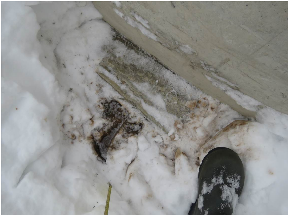
Рис. 3.1.5. Отсутствие горизонтальной гидроизоляции фундаментной плиты из 2 слоев гидростеклоизола
