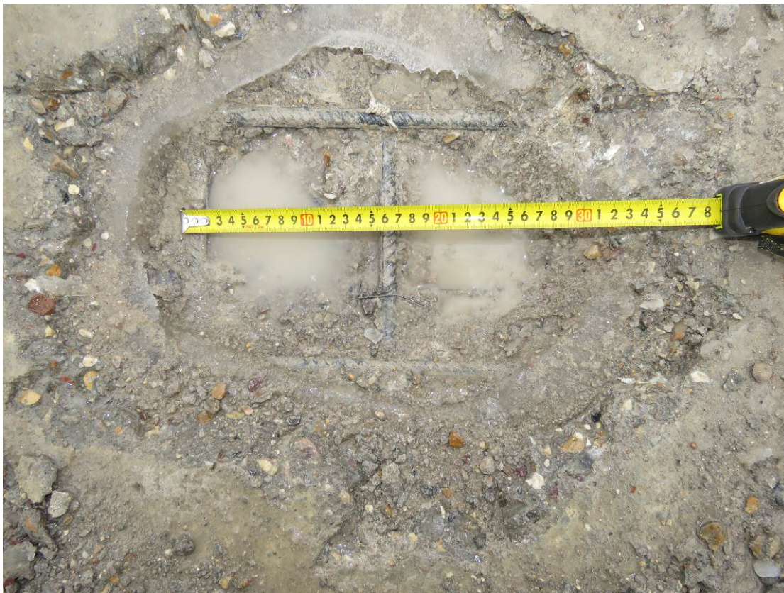
Рис. 3.1.6. Общий вид вскрытия фундаментной плиты в верхней зоне на пересечении осей РР-ТТ и 11-14
